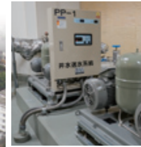
5 9 崇貞館・理化学館 地下水利用システム
