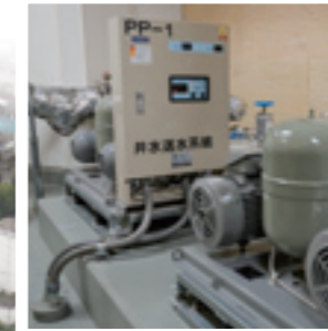
5 9 崇貞館・理化学館 地下水利用システム
